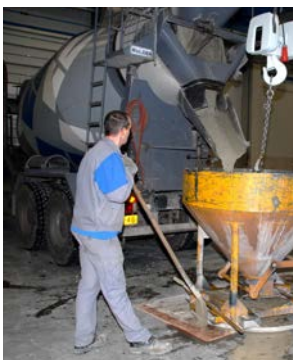
Uusien betonin raaka-aineiden koostumuksen vuoksi on betonista tullut liukkaampaa.
